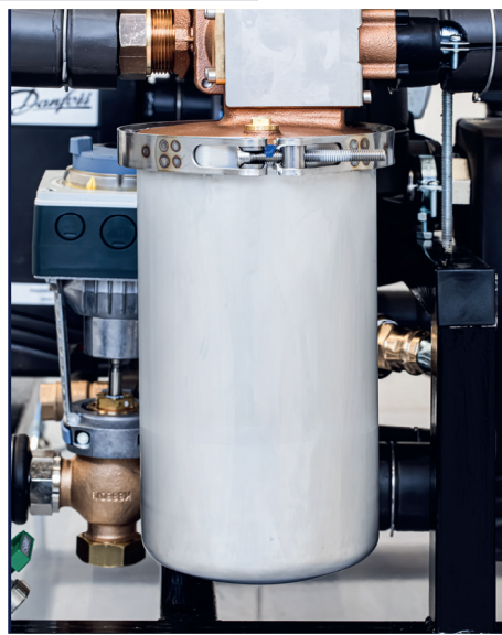
Installierter Impfkristallspender IKS1
