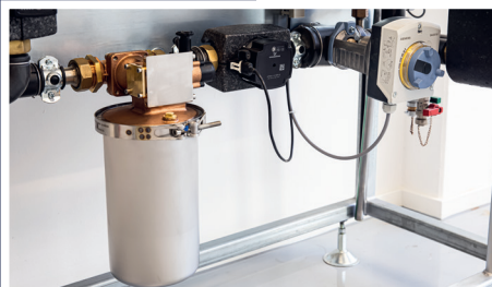
Harmonisieren perfekt: IKS 1, Pumpe, Speicherladeventil (v. l. n. r.)
